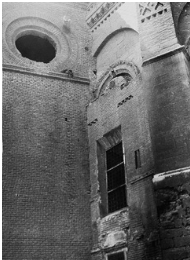
Fig. 10. Imagen inédita del estado de los ábsides de la catedral de la Seo en 1956, antes de la restauración del arquitecto Manuel Lorente Junquera. Archivo General de la Administración.
