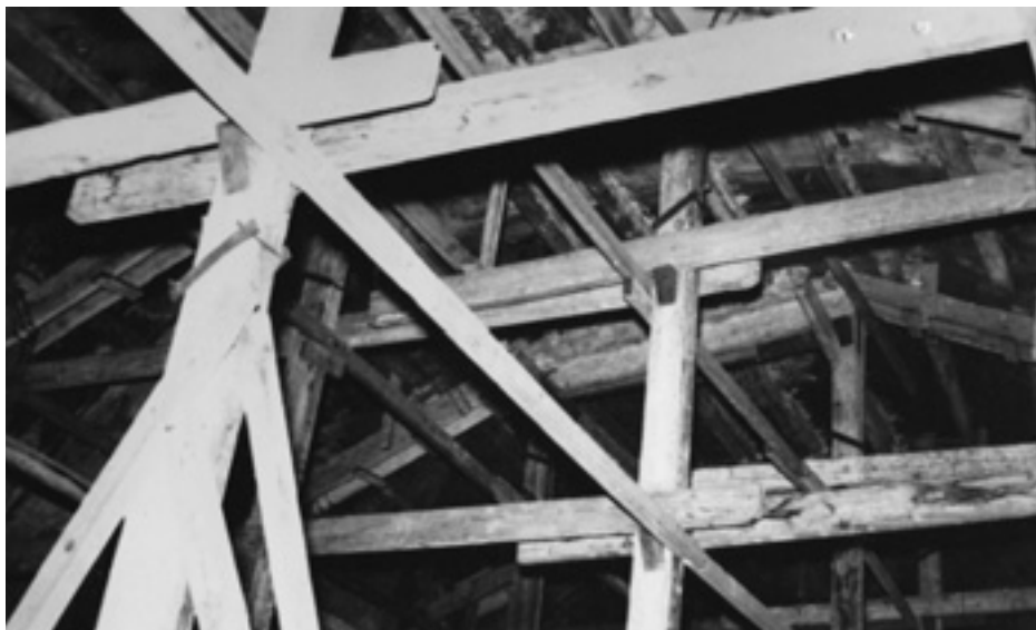
Figs. 8 y 9. Detalle de los andamiajes colocados en la nave para asegurar la estructura de la iglesia. En la fotografía podemos apreciar los restos de pintura de los intradoses de los arcos de acceso a las capillas y los arquivoltas. AMZ, caja 9.360, exp. 2.838/1966, «Arzobispo de Zaragoza. Derribo edificio antigua Iglesia y casa aneja San Juan y San Pedro» (Manuel Pola Serrano).
