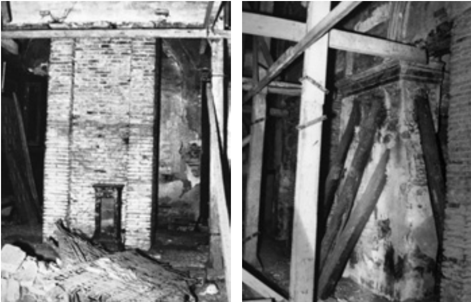
Figs. 6 y 7. En estas imágenes podemos ver los refuerzos de ladrillo instalados para sostener la estructura de la iglesia y los maderos apuntalando los muros de la nave. Este hecho, unido a los escombros y la suciedad acumulada dan una idea del total estado de abandono en el que se encontraba la iglesia. AMZ, caja 9.360, exp. 2.838/1966, «Arzobispo de Zaragoza. Derribo edificio antigua Iglesia y casa aneja San Juan y San Pedro» (Manuel Pola Serrano).
