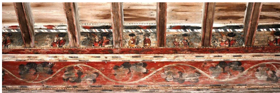
Vista general de la viga de los danzantes. Techumbre del Palacio del Arzobispo de Narbonne en Capestang.
