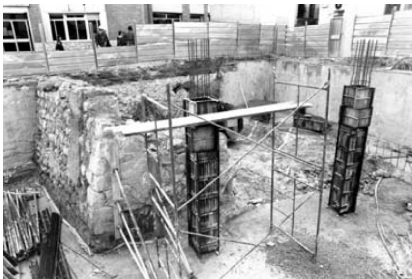
Fig. 17. Proceso de demolición del Portal de Zaragoza: la excavadora de gran tamaño ya había dejado paso al martillo de una miniexcavadora, que efectuará un trabajo más “delicado”. Solo subsistía el paramento exterior de la torre del último cuarto del siglo XIV. Las restantes estructuras y fases de la muralla habían sido definitivamente “saneadas”.
