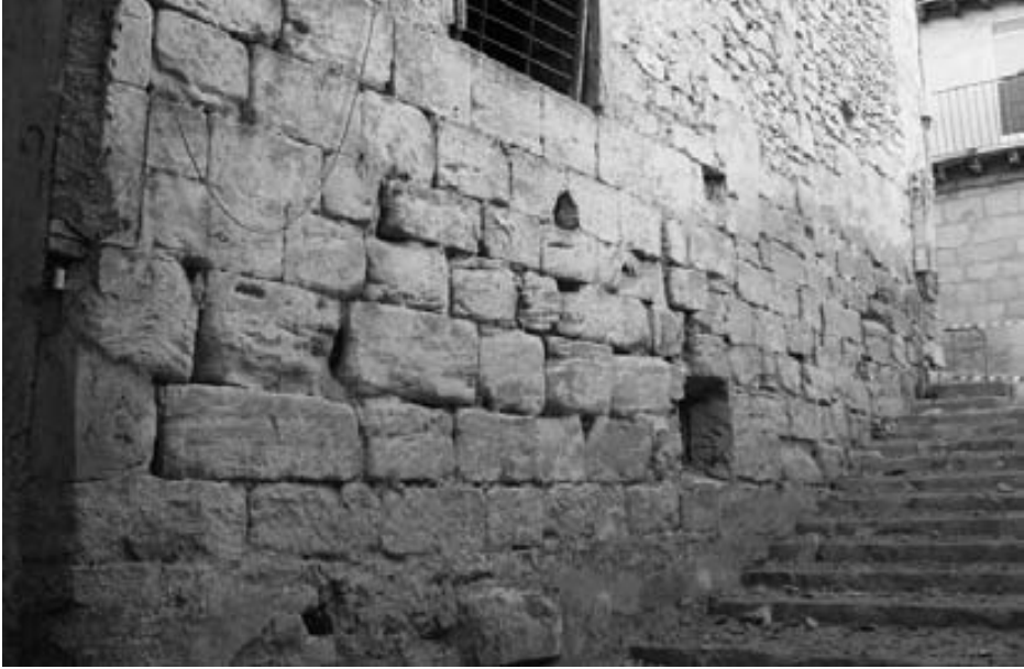
Fig. 11. Aspecto del tramo de muralla del antiguo recinto medieval de Valderrobres conservado en la planta baja del edificio de C/ Santiago Hernández, 20.
